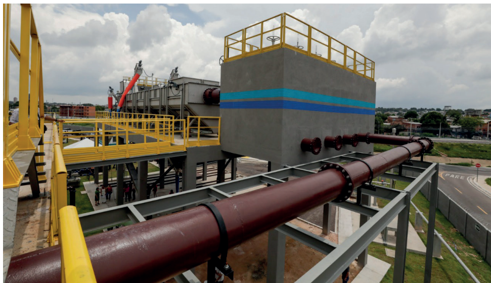
A ETE Raiz soma-se a outros investimentos do Governo do Amazonas para ampliar a cobertura da rede de esgoto na capital, e atende os bairros Raiz, Petrópolis, Cachoeirinha e São Francisco
